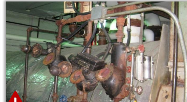
Skorodowane rury rozdzielcze
