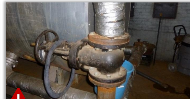
Uszkodzone rurociągi dystrybucji ciepła
