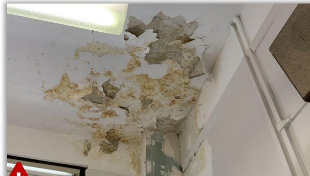
石膏/内部装修破损
