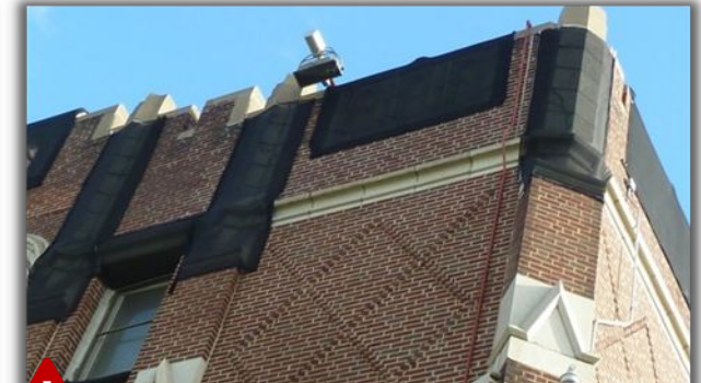
暂射固定住的腐蚀砖块
