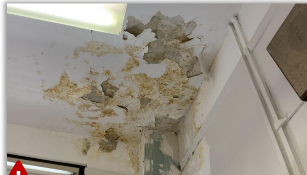
石膏/内部装修破损
