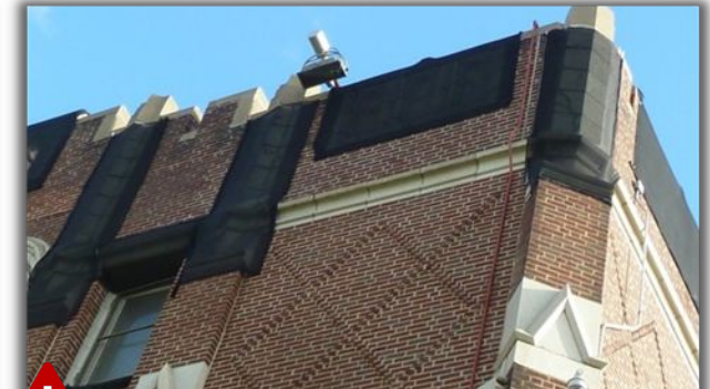
暂时固定住的腐蚀砖块
